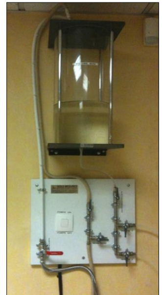
Ensemble réservoir + tableau
